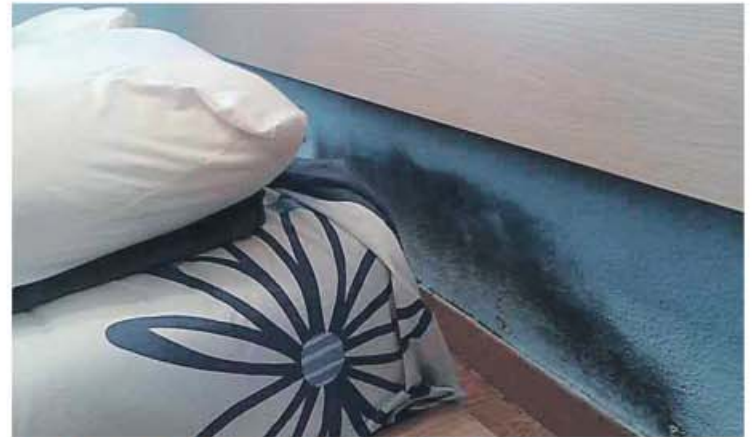
Problemas de humedad por capilaridad
