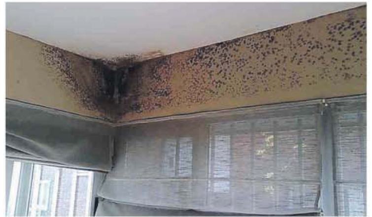
Problemas de humedad por condensación
