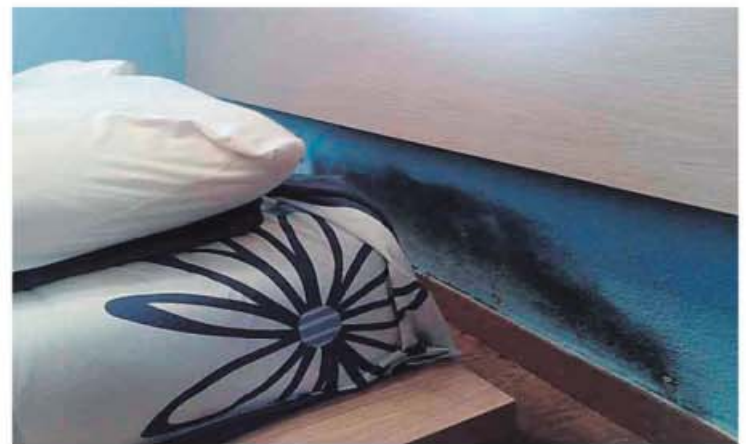
Problemas de humedades por capilaridad
