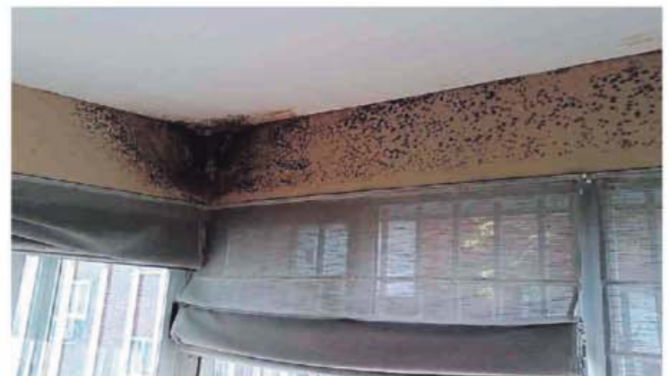
Problemas de humedades por condensación
