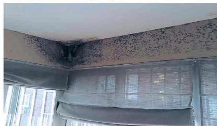
Problemas de humedades por condensación
