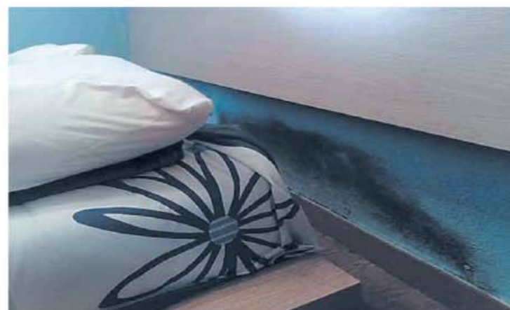
Problemas de humedades por capilaridad
