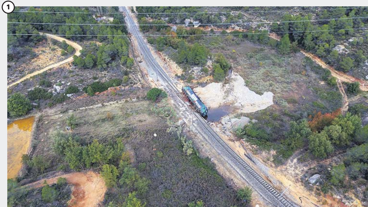
Daños en la línea de ferrocarril entre Lleida y Tarragona
