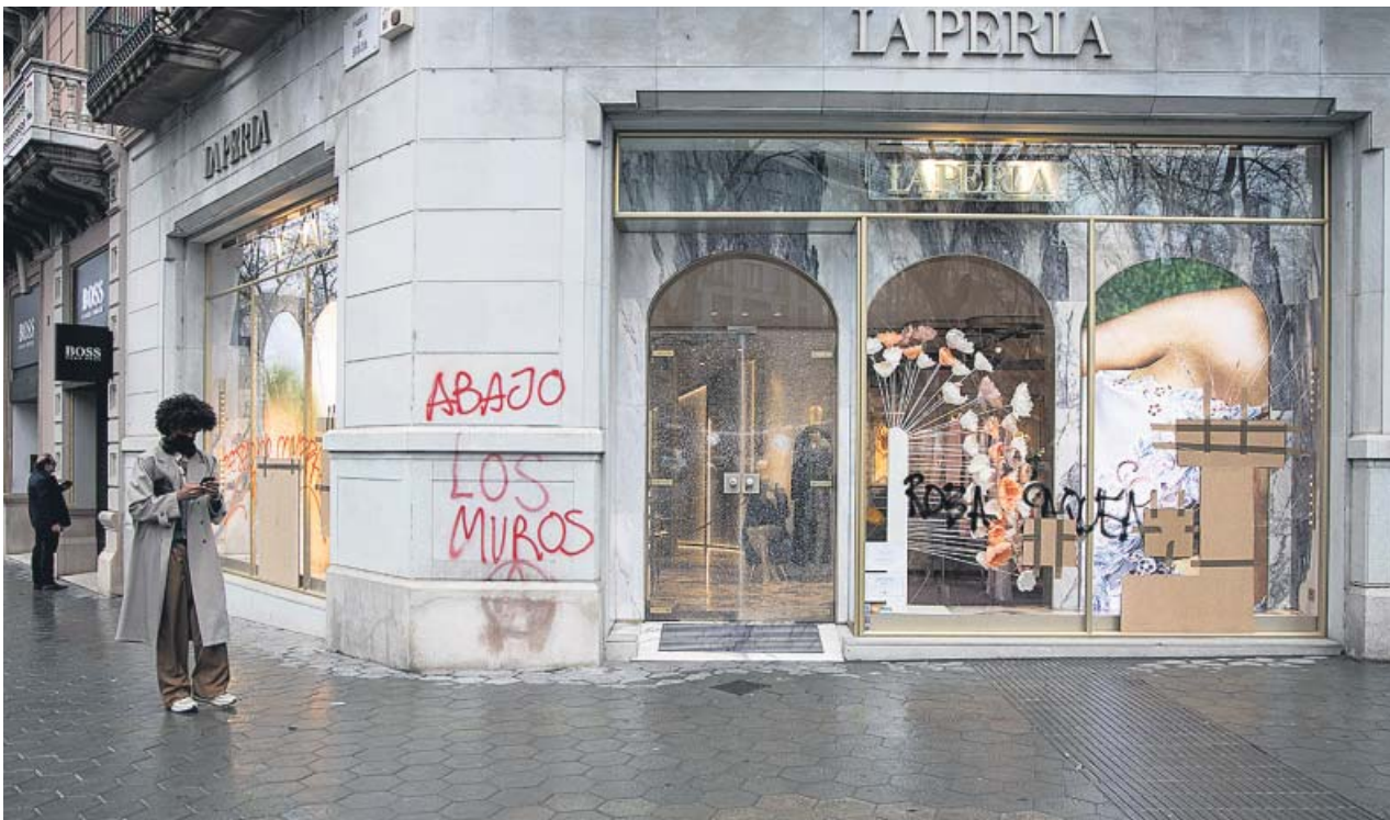
Pintadas en las paredes, mobiliario urbano deteriorado y escaparates rotos era la imagen ayer en el passeig de Gràcia. HUGO FERNÁNDEZ
