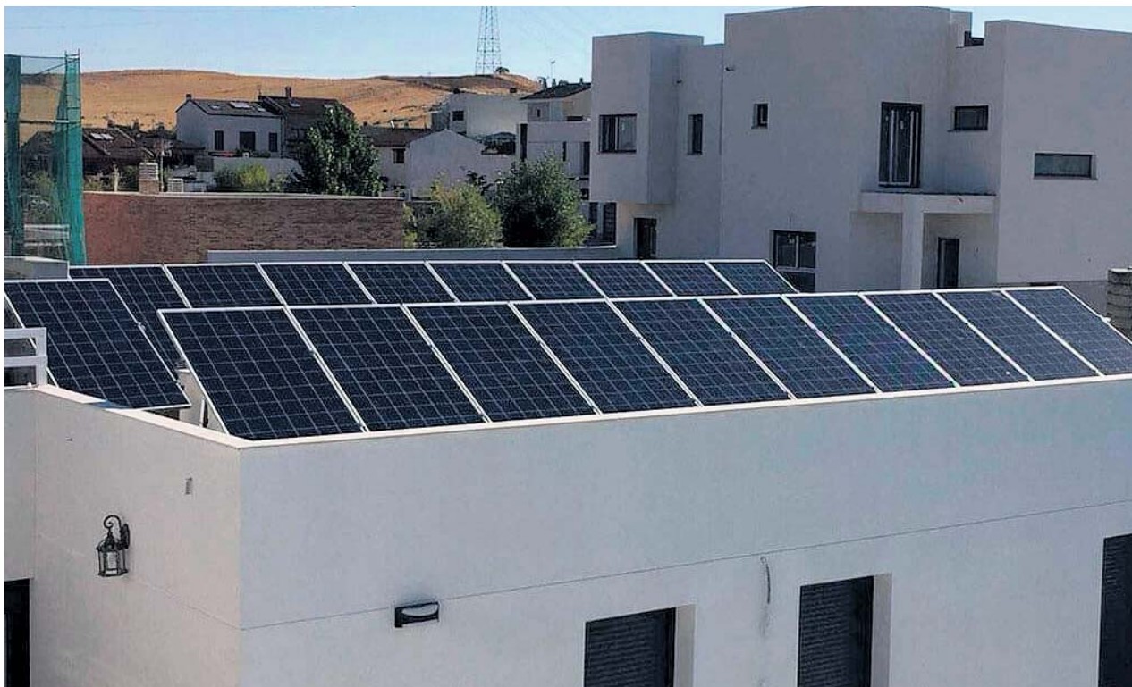
Placas solares en una vivienda de autoconsumo, en Madrid. CAMBIOENERGETICO.COM
