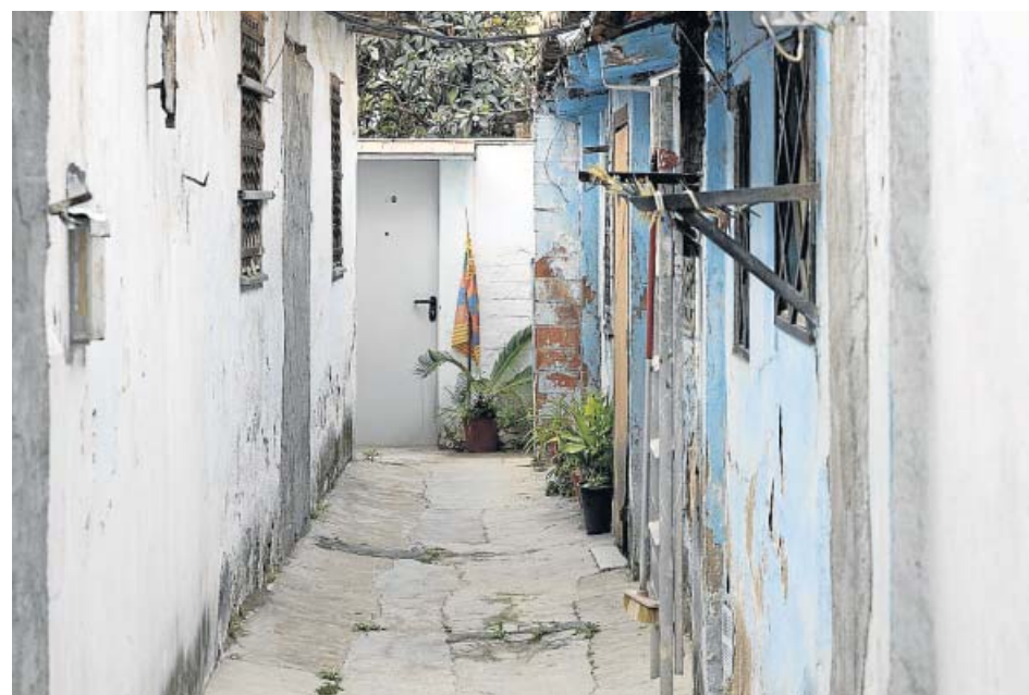
Los vecinos esperan el nuevo edificio mientras sus viviendas se degradan. MIQUEL TAVERNA
