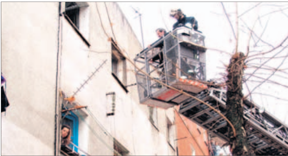
Derrumbe. Los bomberos trabajan en la corrala de Getafe accidentada ayer.
