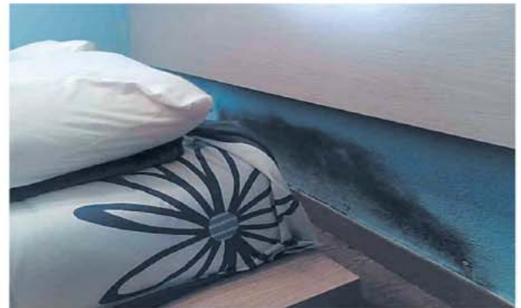
Problemas de humedades por capilaridad
