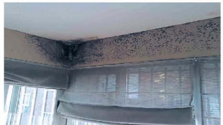
Problemas de humedades por condensación
