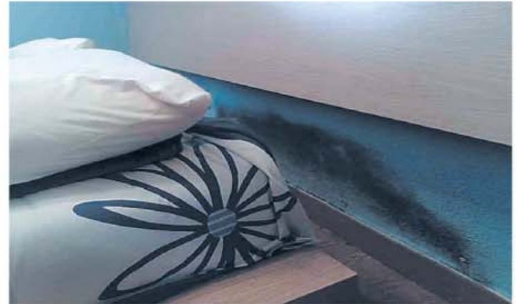
Problemas de humedades por capilaridad
