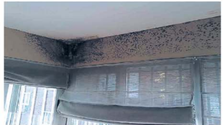
Problemas de humedades por condensación
