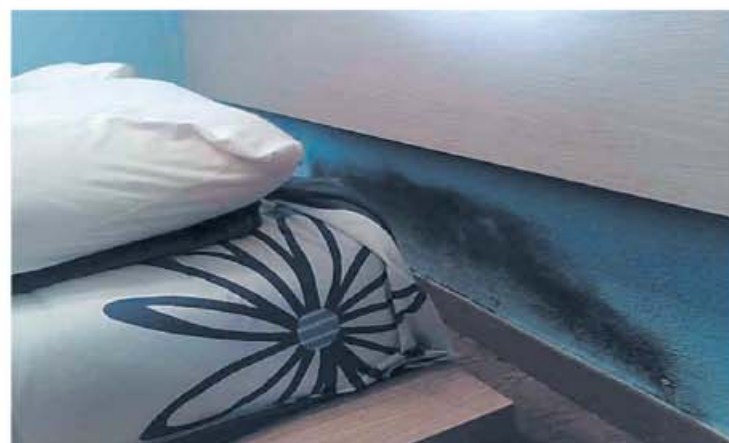
Problemas de humedades por capilaridad
