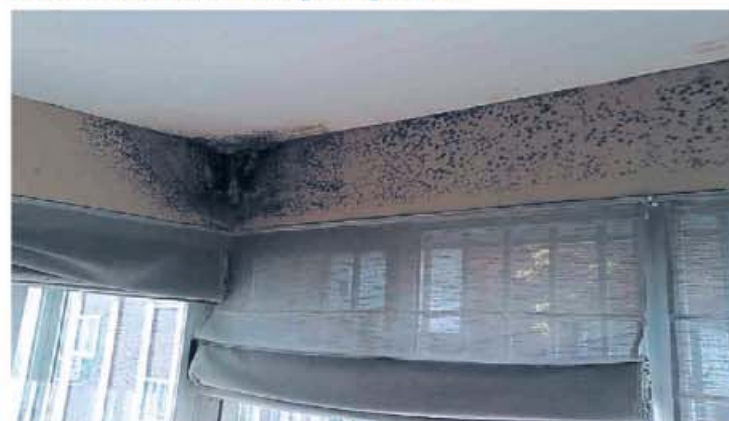
Problemas de humedades por condensación
