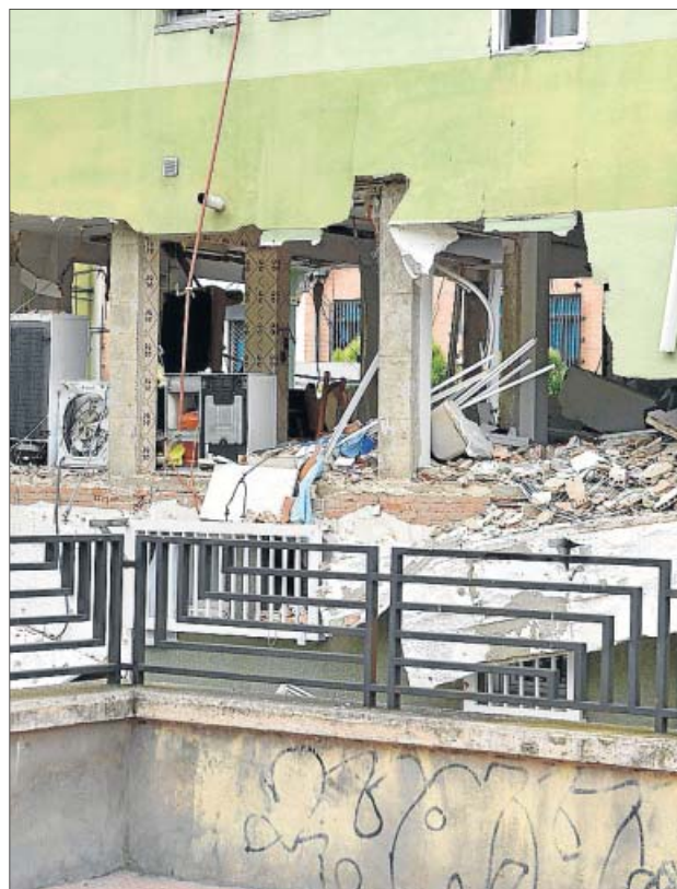
Destrozos del edificio donde se produjo la explosión. FERNANDO VILLAR / EFE
