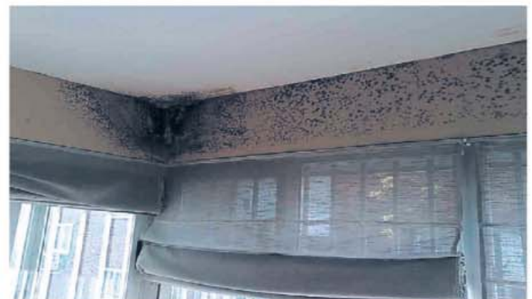
Problemas de humedades por condensación
