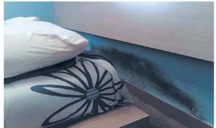
Problemas de humedades por capilaridad
