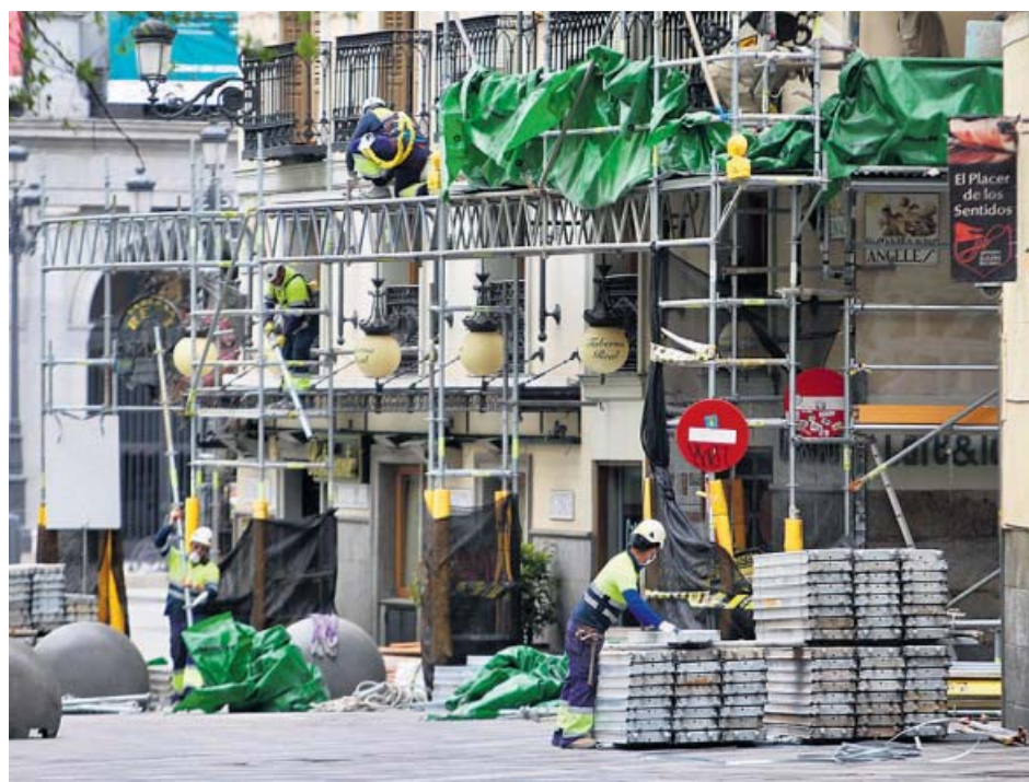
Obreros de la construcción trabajando en un céntrico edificio de Madrid. JORGE PARÍS
