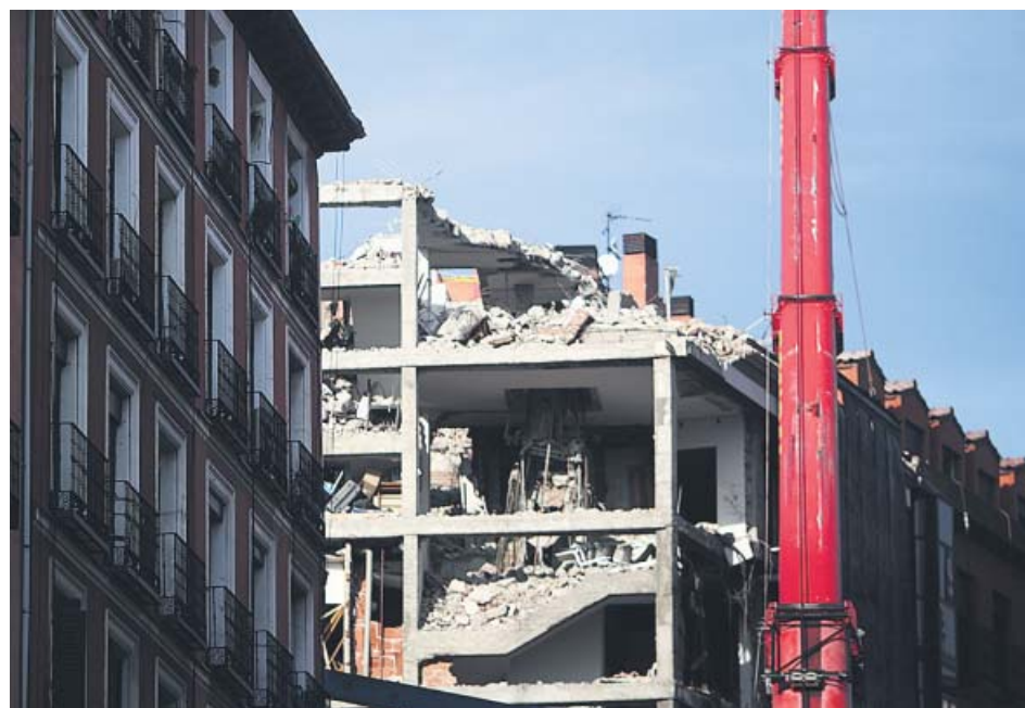
Una grúa trabajaba esta semana en el derribo de las plantas superiores. JORGE PARÍS
