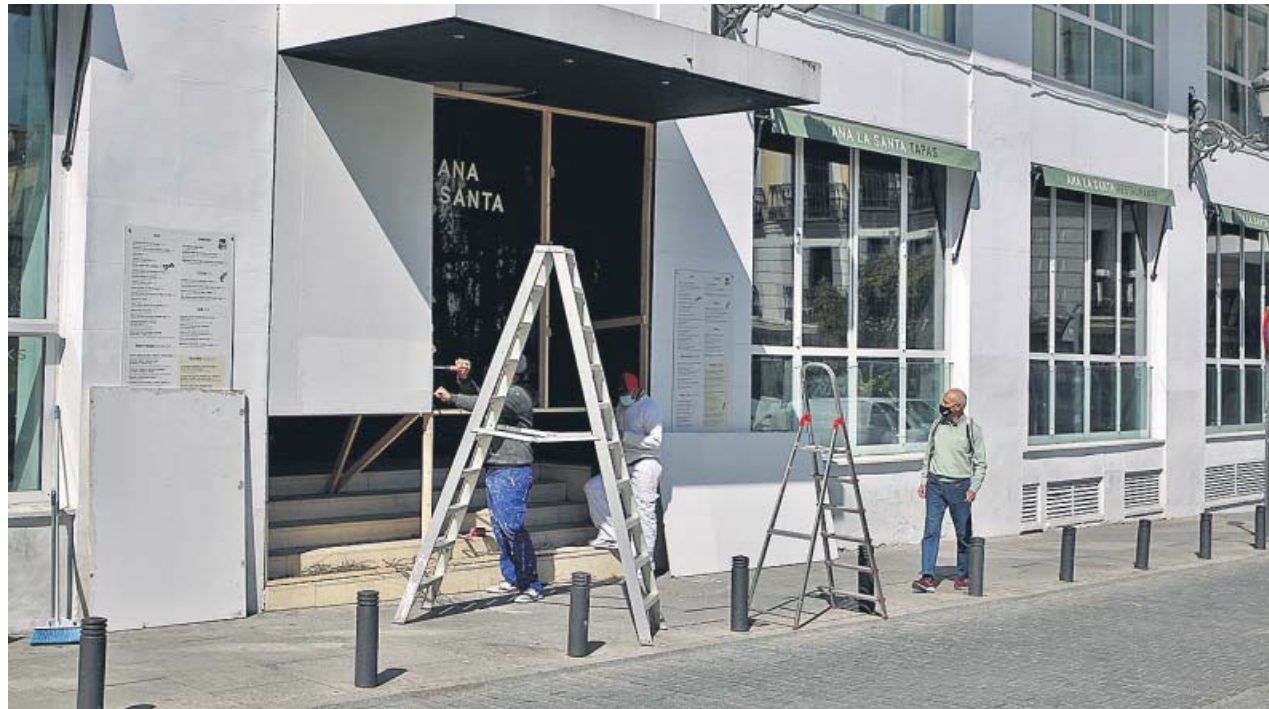
Operarios de reformas trabajando en la fachada de un hotel céntrico de Madrid. JORGE PARÍS
