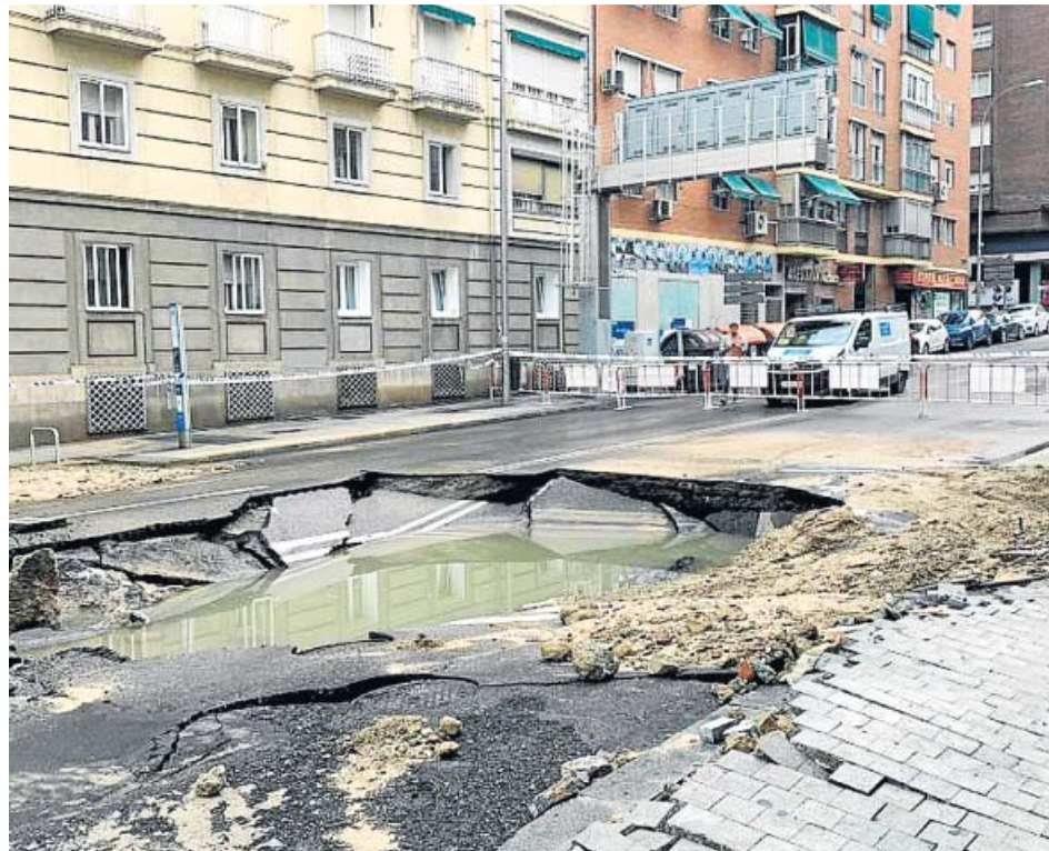
Socavón provocado por la rotura de una tubería en septiembre en Marqués de Vadillo. JOSÉ GONZÁLEZ
