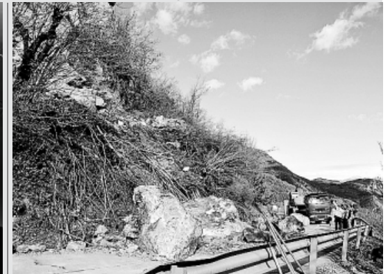
CARRETERA CORTADA. Un desprendimiento de unas 100 toneladas de piedras bloquearon ayer la N-260, a la altura del municipio leridano de Viu de Llevata. FOTOS: EFE
