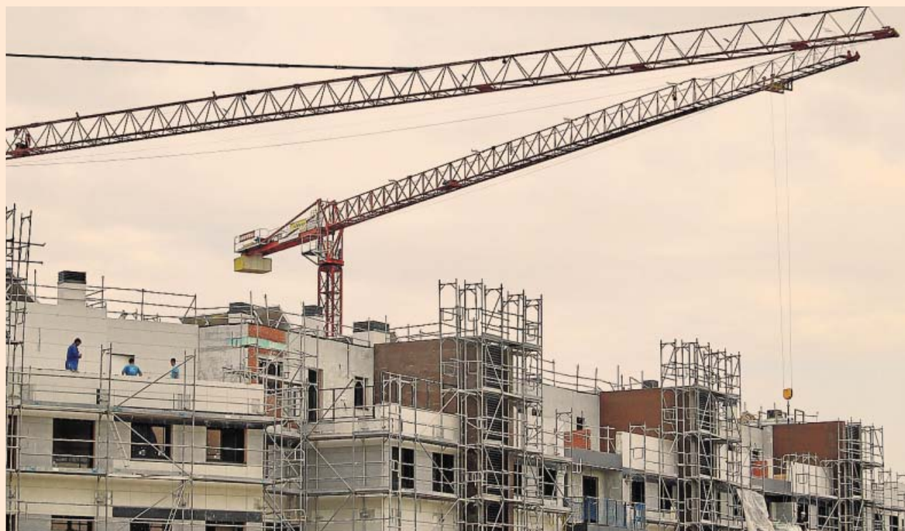
Obras de construcción de vivienda nueva en Madrid, una de las ciudades donde más se ha reactivado. JORGE PARÍS
