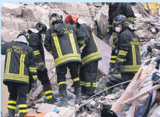
DERRUMBE EN ITALIA. Bomberos encuentran el cadáver de una víctima tras el derrumbe de dos edificios en Palermo, donde tres personas murieron ayer. EFE
