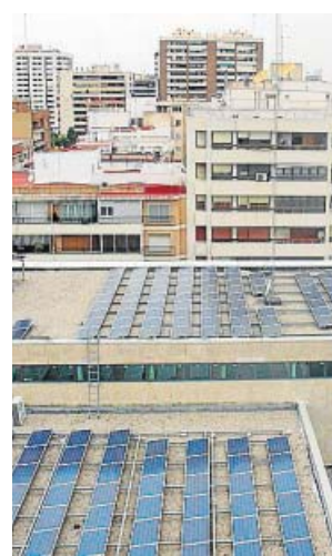
Paneles solares instalados en la azotea de unos edificios. ARCHIVO
