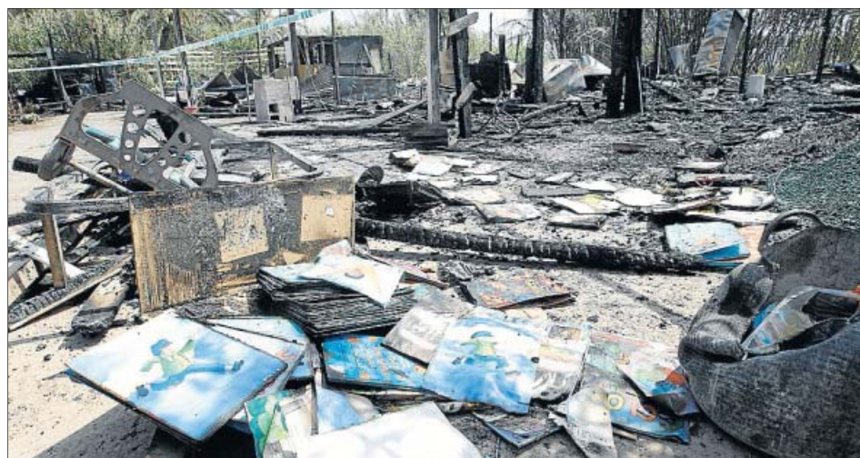
Las infraviviendas quedaron totalmente arrasadas por las llamas.
