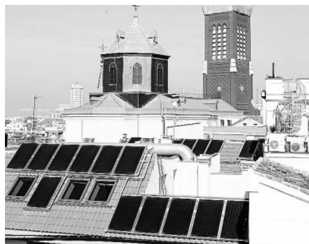
Paneles solares instalados en el tejado de un edificio.
