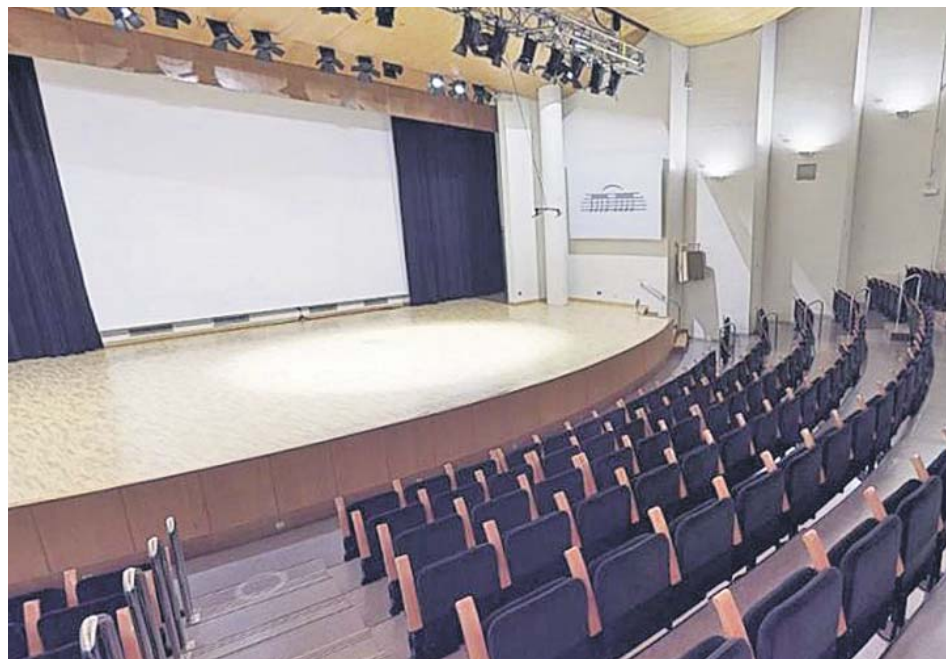
Sala Rodrigo del Palau de la Música de València, en la que se ha desprendido parte del techo.
