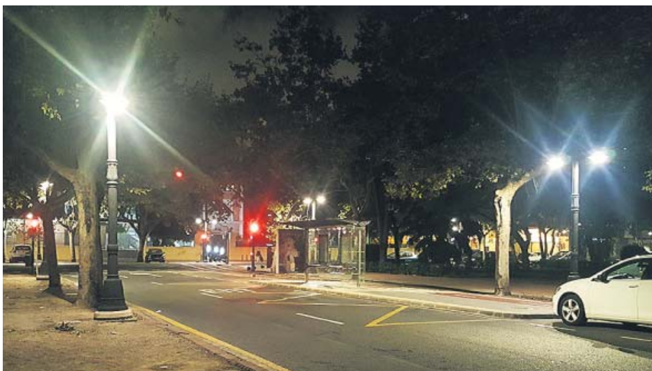
En la imagen superior, el modelo València, con la nueva luminaria. Abajo, encendidas.
