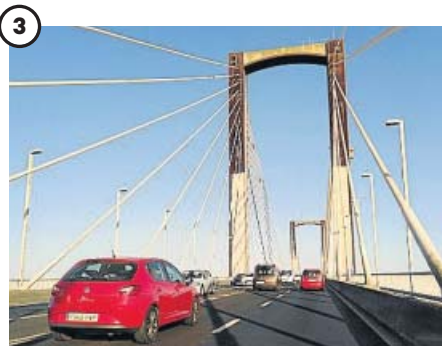
Puente del V Centenario (Sevilla) El Puente del Centenario concentra numerosos accidentes ya que se encuentra en una vía de circunvalación (la SE-30) y supone una de las principales entradas al centro de Sevilla.
