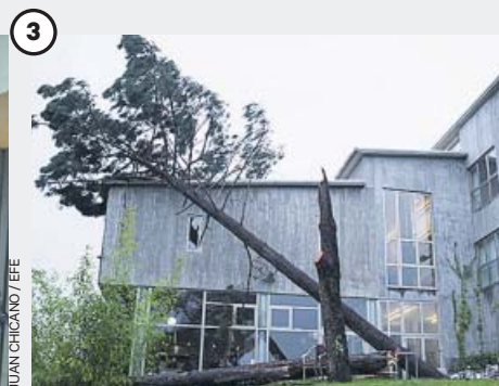
Caídas de árboles y cortes en Ourense En Ourense amanecieron con árboles y mobiliario urbano destrozado, cortando las vías de carretera y ferroviarias. En la foto, un árbol caído junto a la Escuela de Arte de Antonio Faílde.
