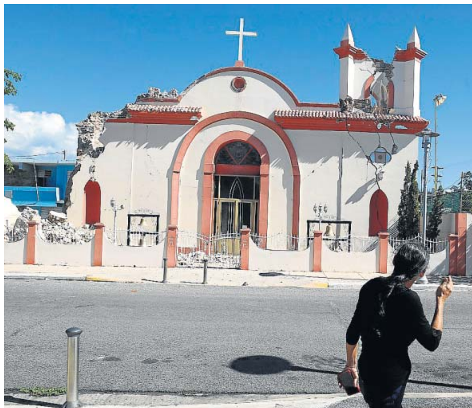
Un hombre camina frente a una parroquia afectada por el terremoto registrado ayer. THAIS LLORCA/EFE
