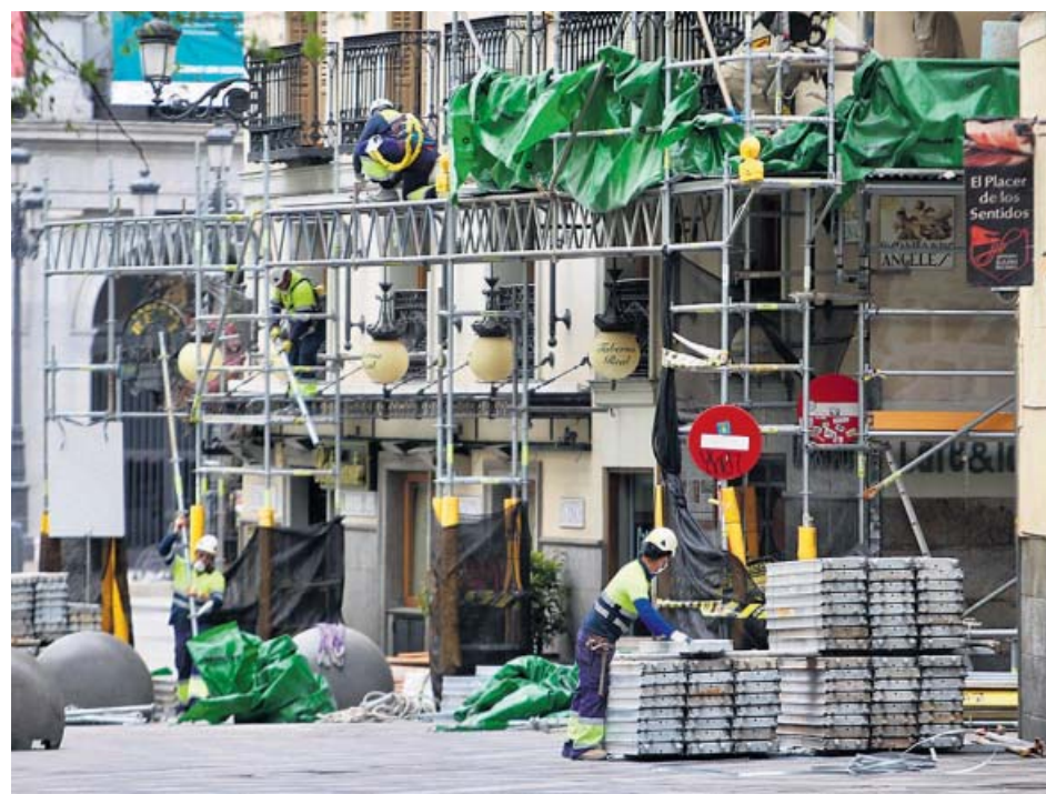
Obreros de la construcción trabajando en un céntrico edificio de Madrid. JORGE PARÍS
