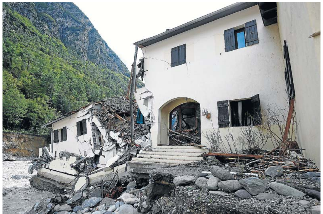
Imagen de los destrozos causados en una casa por las inundaciones de los últimos días en Francia. EFE
