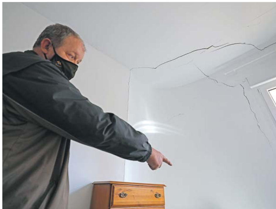
Un vecino de Granada muestra las grietas causadas en su casa tras un reciente terremoto. EUROPA PRESS
