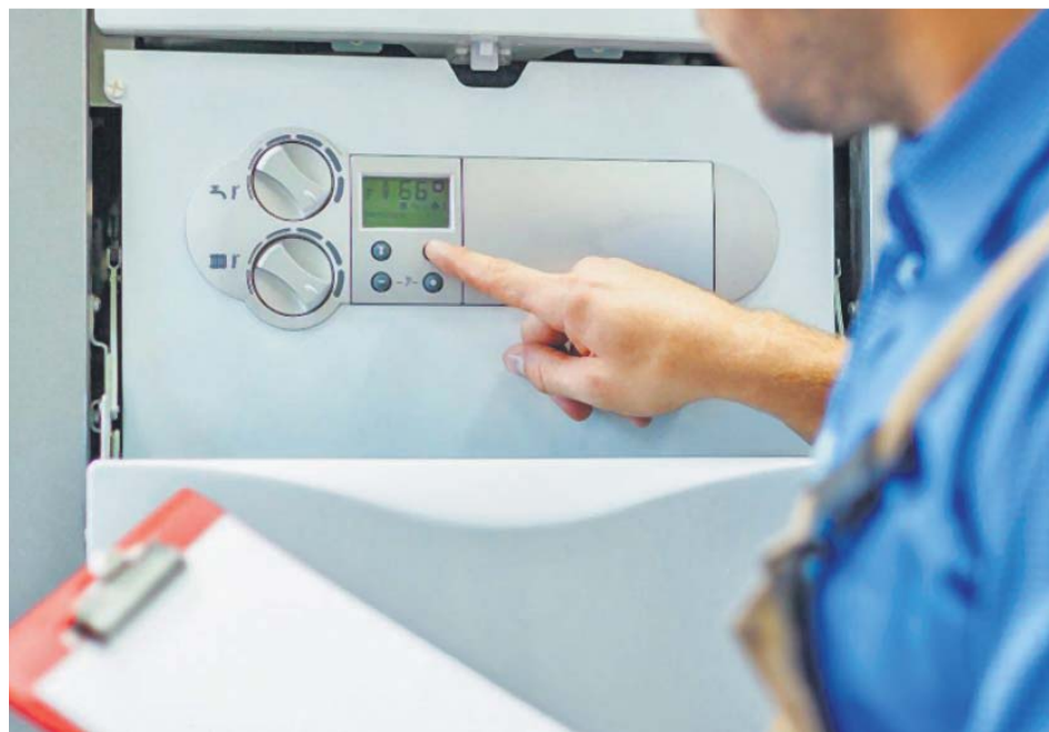
Un técnico realizando la revisión de una caldera de gas. JORGE PARÍS
