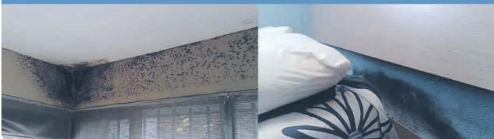
Problemas de humedades por condensación y por capilaridad
