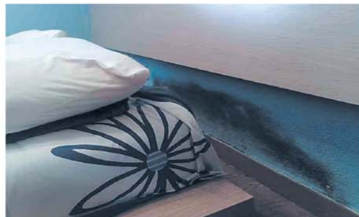
Problemas de humedades por capilaridad
