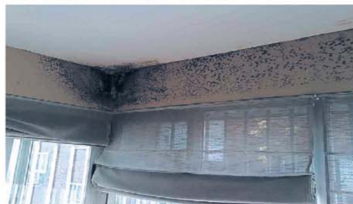
Problemas de humedades por condensación
